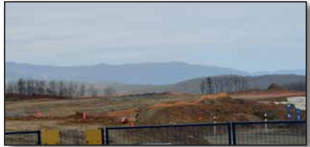
Εικόνα 5: Στο βαθμό που μπορείς να διακρίνεις, έχει δημιουργηθεί πλάτωμα για την εγκατάσταση εργοστασίου. Χωρίς την απαιτούμενη άδεια από τη Πολεοδομία και ενώ έχει καταγγελθεί, τα έργα συνεχίζονται κανονικά
