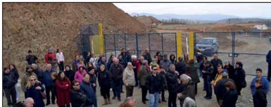
Εικόνα 3 Πρώτο σημείο συνάντησης: Η θέση κατασκευής του εργοστασίου επεξεργασίας. Η εξέλιξη των έργων είναι εμφανής.
